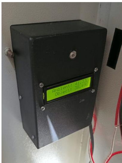
Gambar 4. Prototype yang terpasang pada box panel recloser
